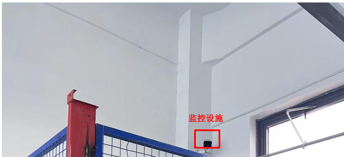
危险废物监控设施
