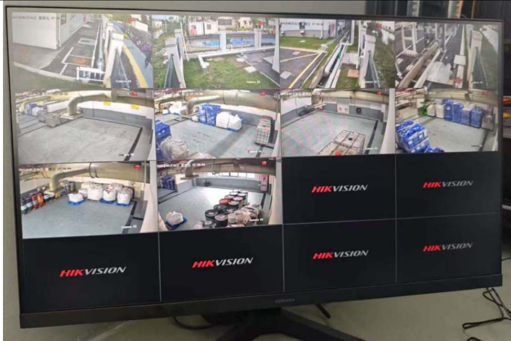
危险废物贮存设施监控影像
