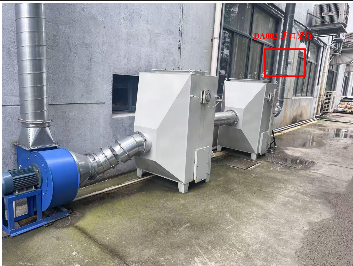
二级活性炭吸附+15m 排气筒
