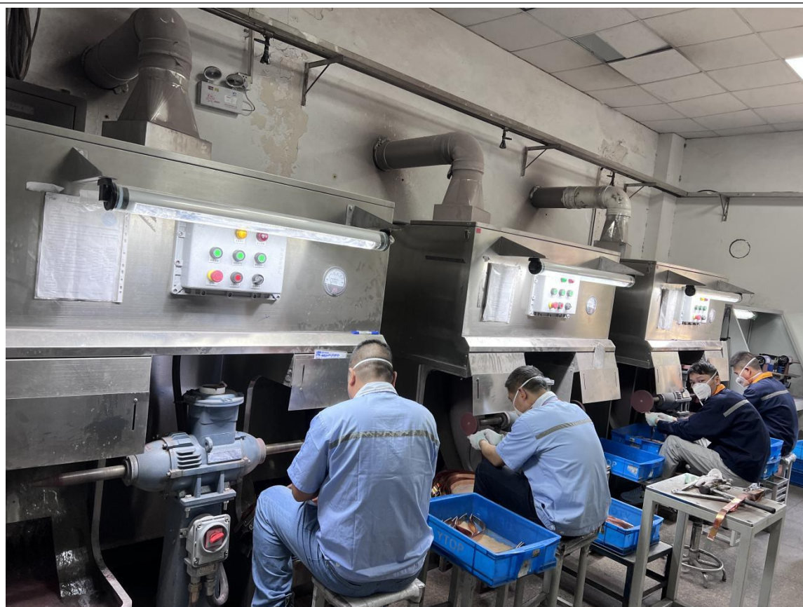
水池除尘设备
