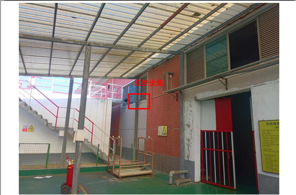
危险废物贮存设施内部情况及监控设施
