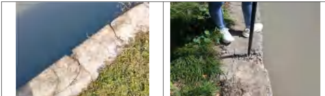
压顶破损、开裂局部图
