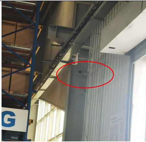
危废仓库外部摄像头
