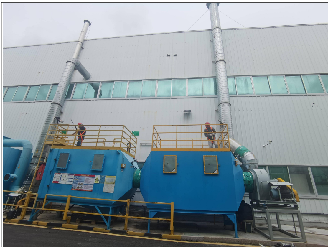
废气处理系统（二级活性炭吸附 TA004）
