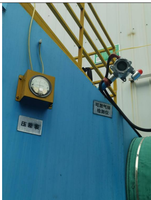
设施进口压差表、可燃气体检测仪
