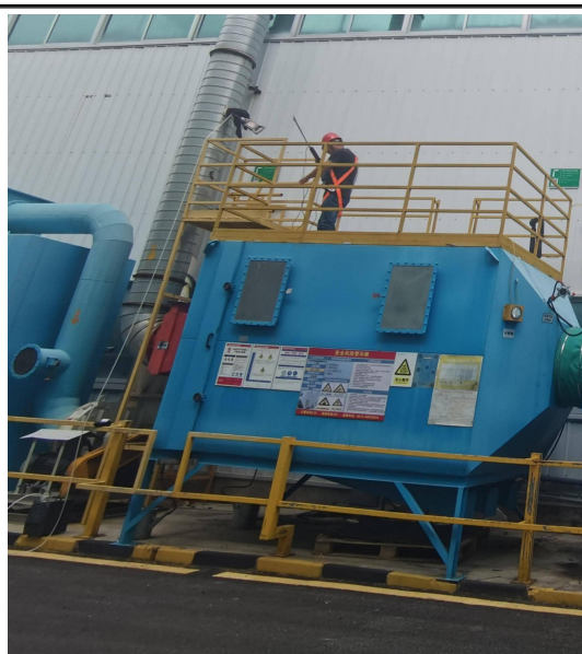
进口取样口及取样平台
