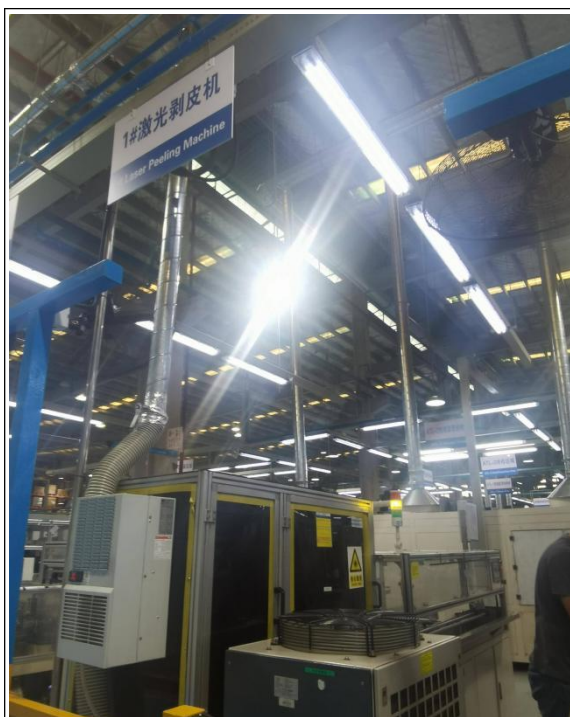
激光剥皮废气收集系统
