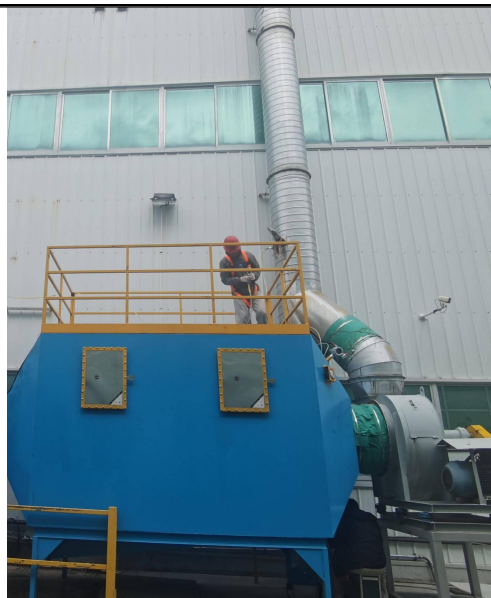
出口取样口及取样平台
