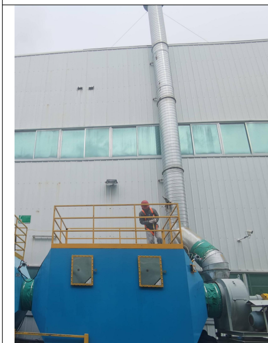
活性炭装置排放口
