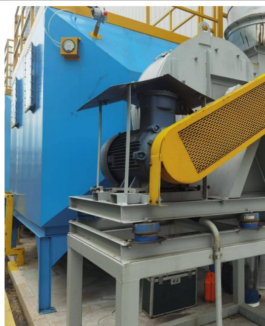
设施出口压差表、可燃气体检测仪
