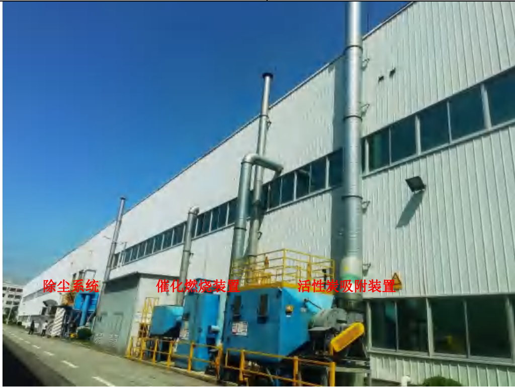
废气处理系统
