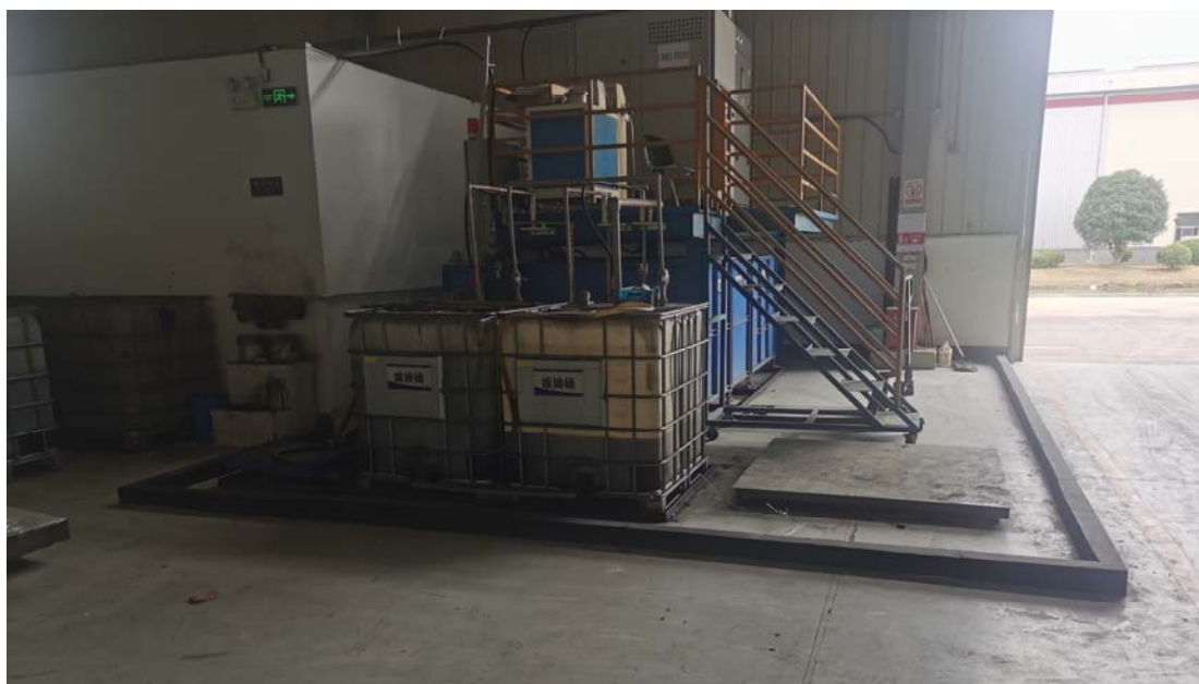
切削液蒸发系统现场图
