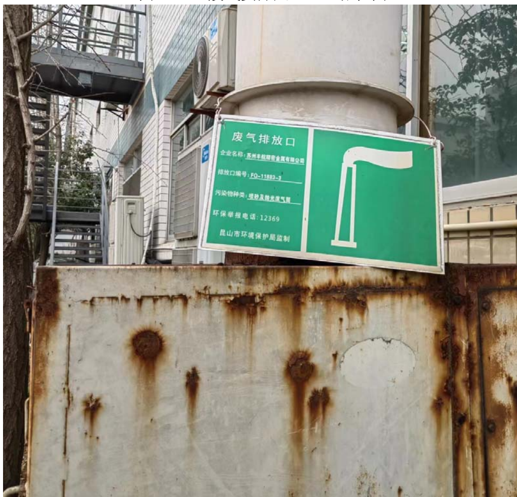
图 4.1-2 喷砂废气排气筒（DA001）
