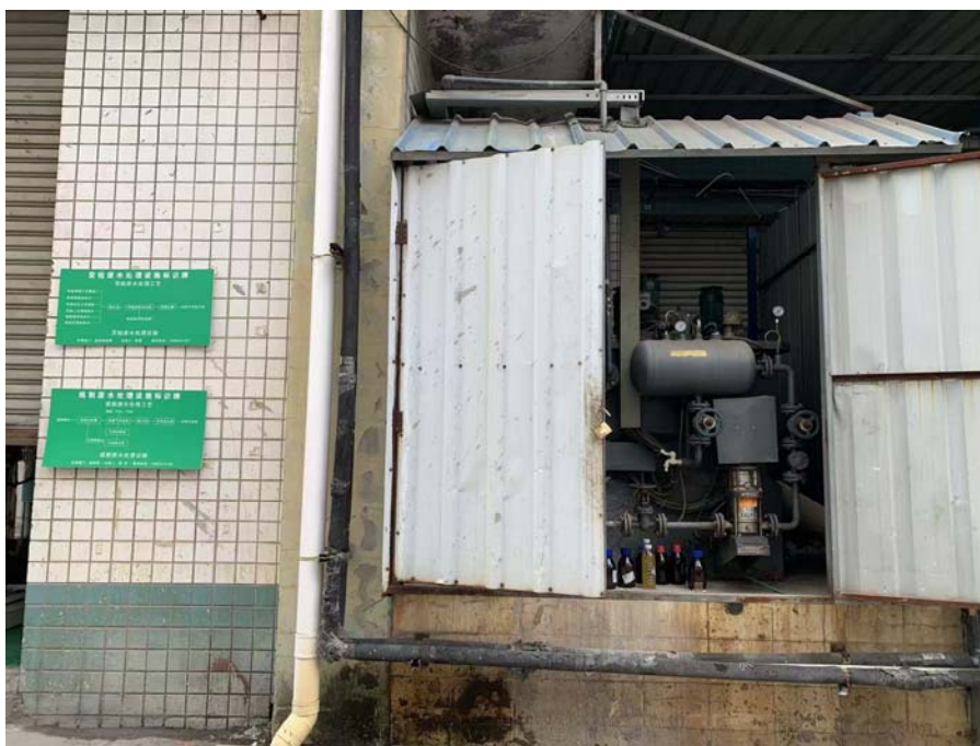
线割废水处理设施
