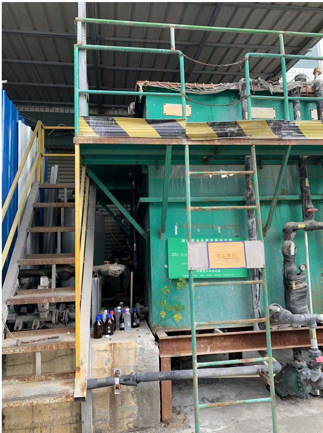
研磨废水处理设施
