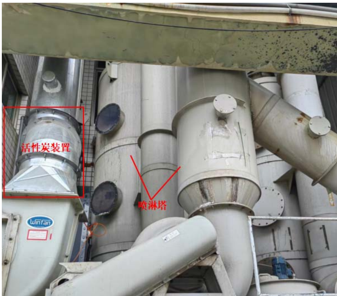
图 4.1-3 颗粒物、有机废气处理（喷淋塔、活性炭装置）
