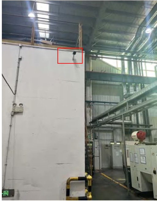
危废贮存设施外监控设施
