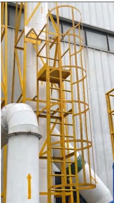
排气筒取样口
