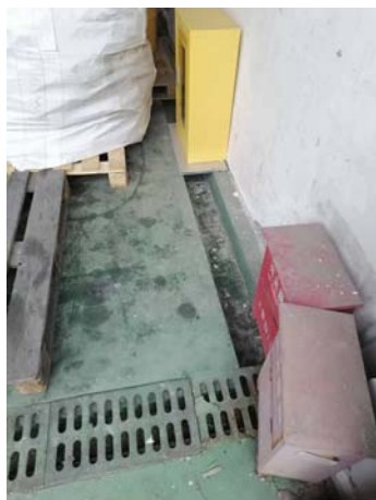
危废仓库防泄漏集液导流沟
