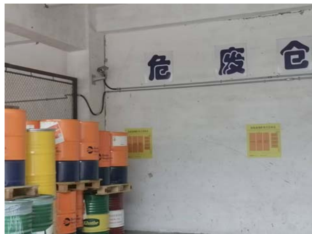
危废仓库监控设施
