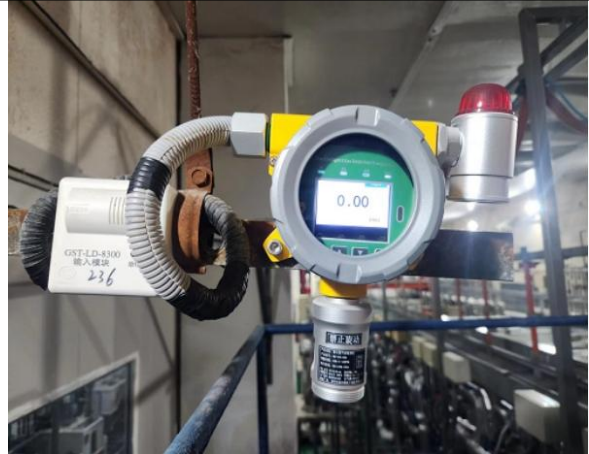
车间有毒有害气体监测 (甲醛、氯化氢、氰化氢、氨气)
