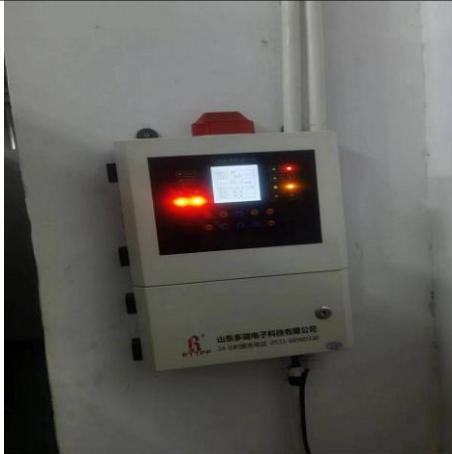
厂界有毒有害气体监测 (甲醛、氯化氢、氰化氢、氨气)
