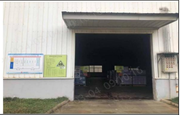
危险废物贮存设施（第 4-2 号）
