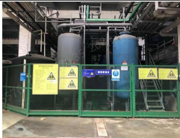
危险废物贮存设施（第 4-3 号）
