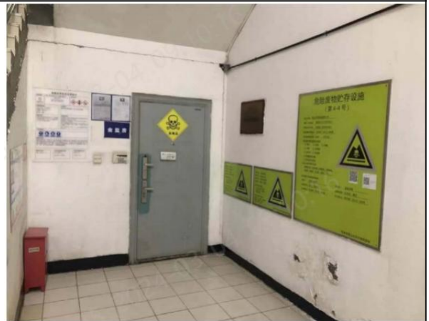
危险废物贮存设施（第 4-4 号）
