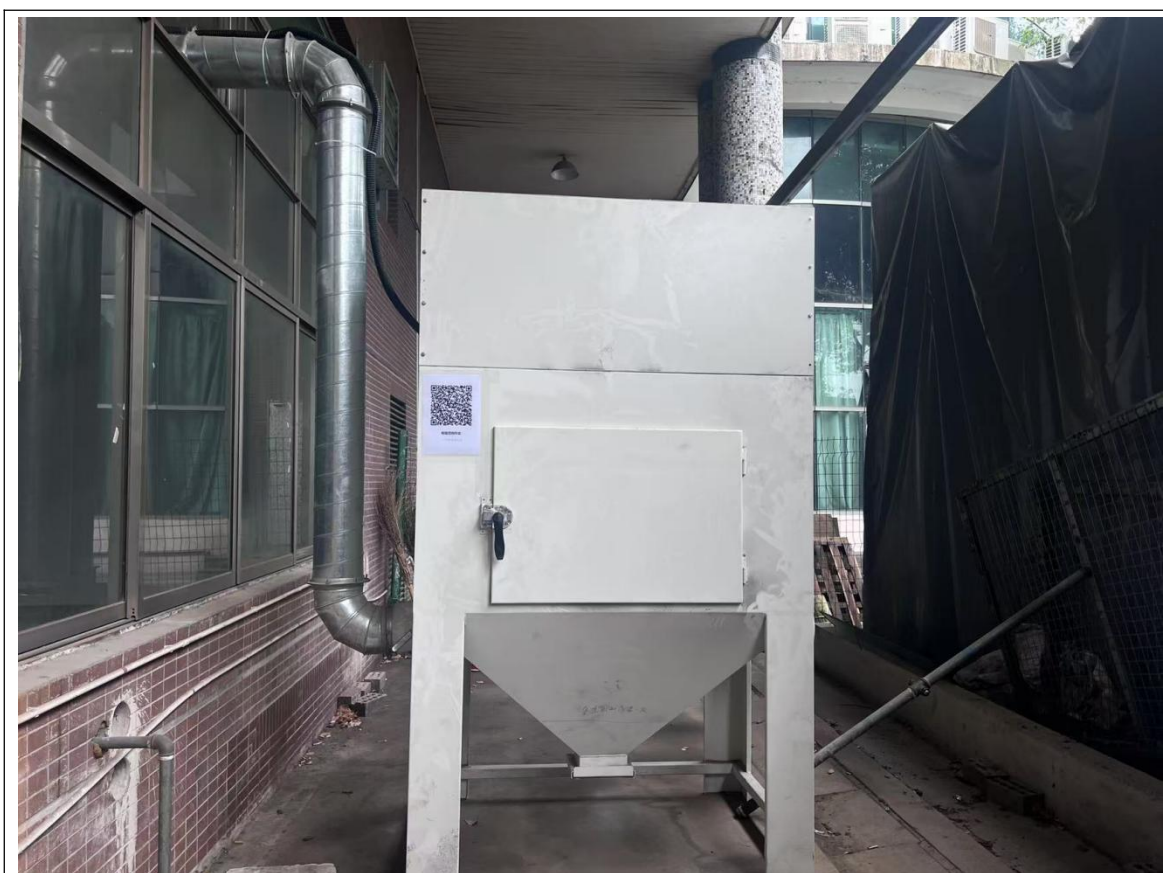
旋风除尘+滤芯除尘装置
