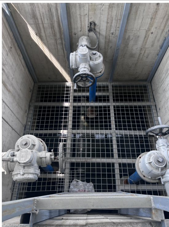
雨水管网、事故池、初期雨水池三通阀
